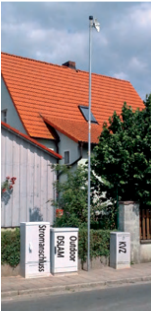
Outdoor-DSLAM mit Richtfunk- anbindung. Quelle: p 2 systems GmbH
