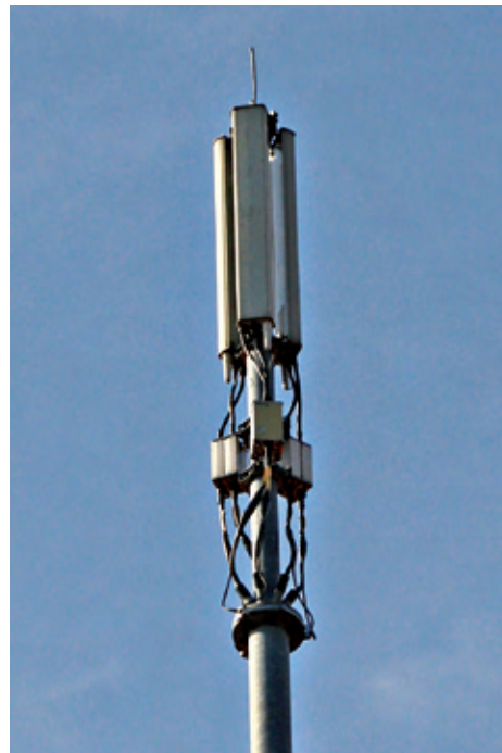
Antennenkonstellation einer typischen Mobilfunkbasisstation mit drei Sektorantennen.
