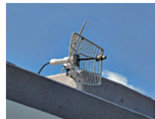
WLAN-Richtfunksystem mit Gitter-Parabolantenne (5,8 GHz).
