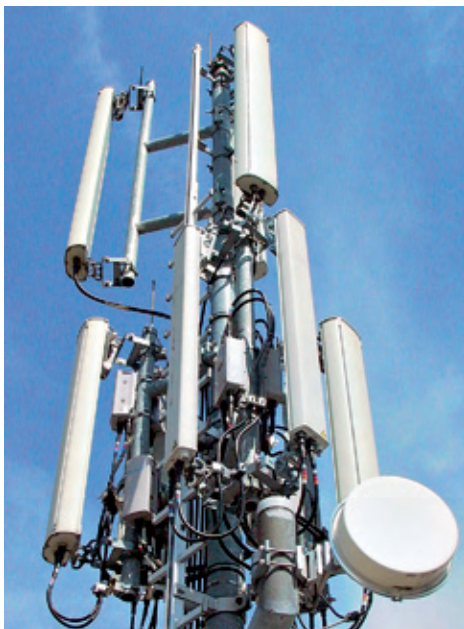
Mobilfunkmast mit Antenne verschiedener Betreiber. Im Bild unten rechts: eine Richtantenne zur Anbindung an die übergeordnete Netzeinheit.
