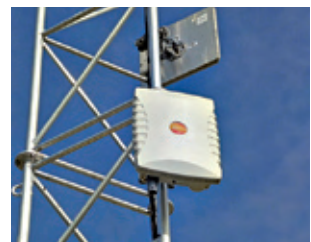
WLAN-Richtfunksystem mit Flachantenne (5,8 GHz).
