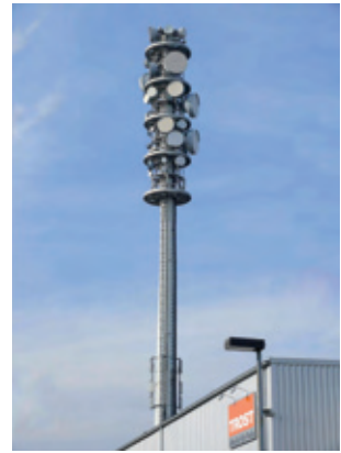
Richtfunkantennen auf einem hohen Mast in Karlsruhe.
